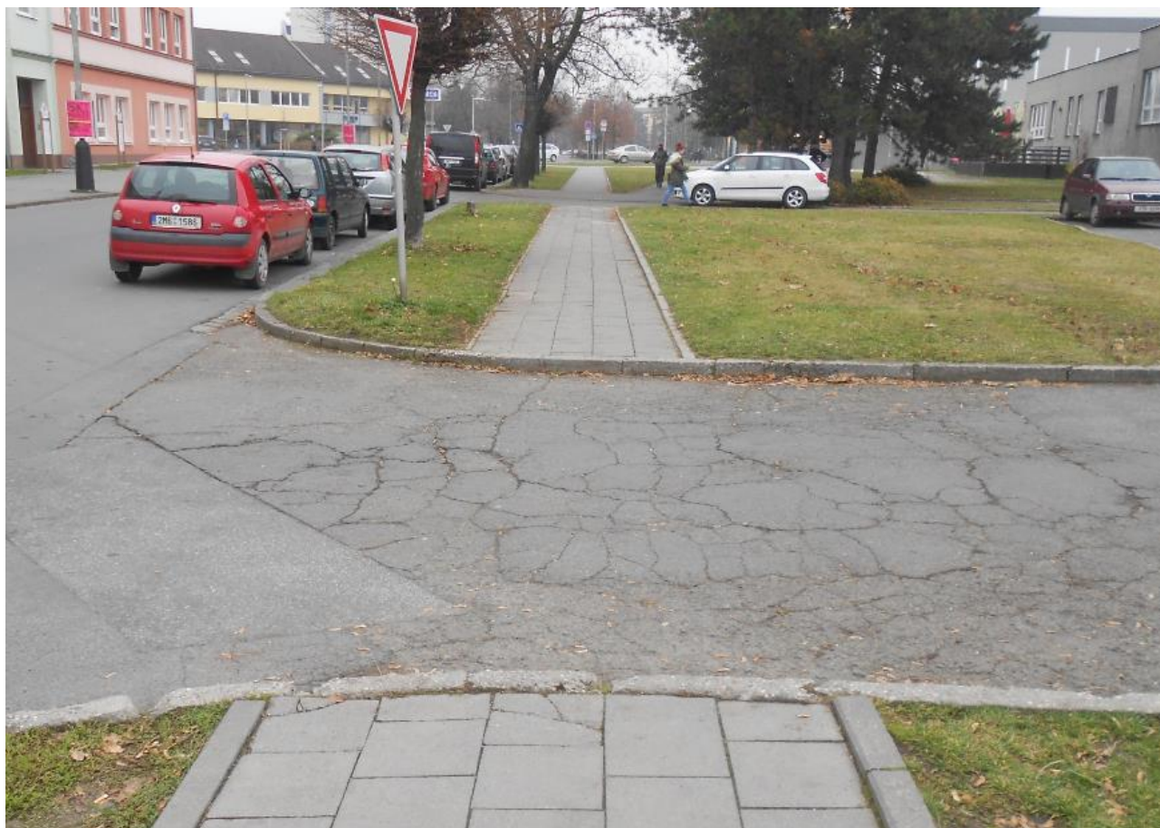
Obrázek 9.9: Nevýhovující místo pro přecházení, napojení parkoviště – obruba nedovoluje průjezd osobám na vozíku, signální a varovný pás chybí; Šířava
